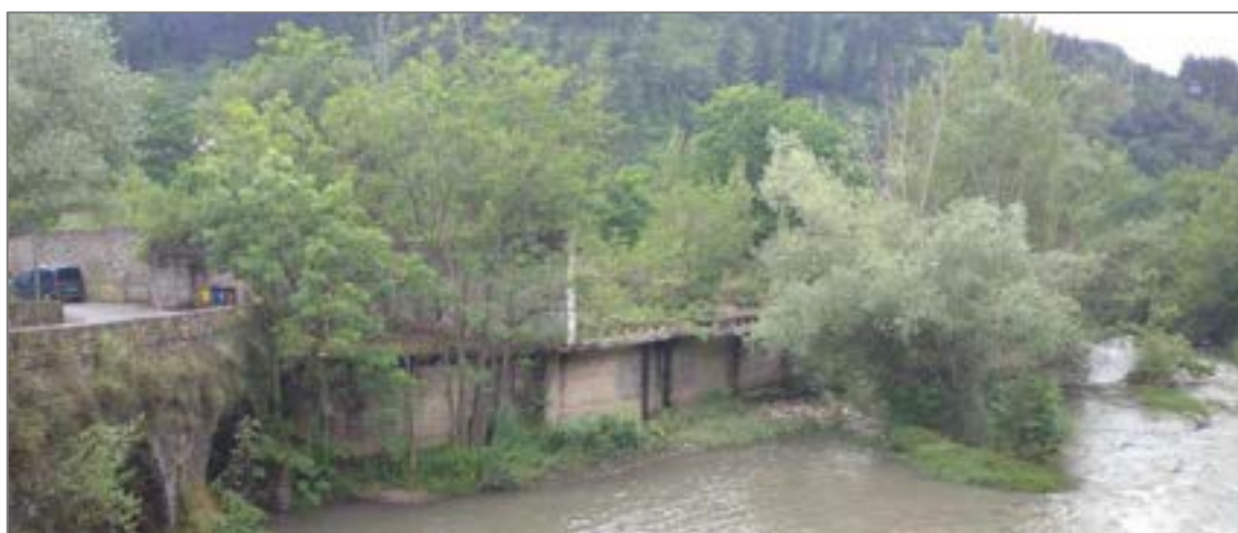
Figura 31. Tramo de muro de encauzamiento con escasez de vegetación de ribera aguas abajo del puente Algodonera
