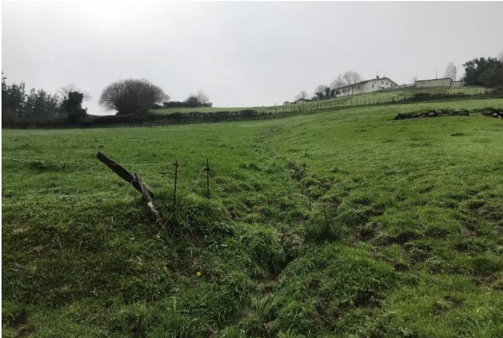
Fig 10: canal o cuneta que concentra sobre la zona deslizada las aguas de escorrentía del terreno.
