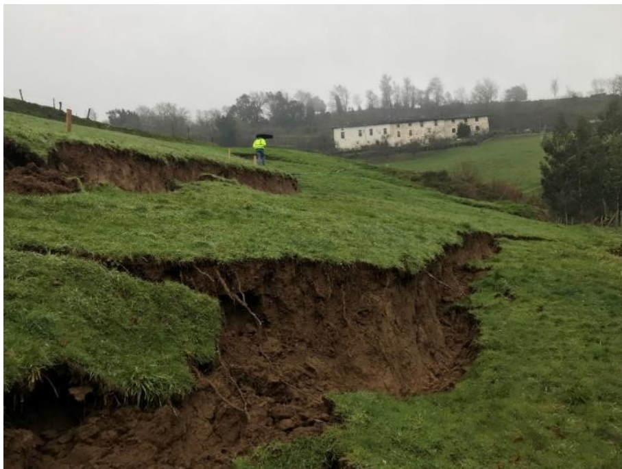
Fig 6: grietas de tracción en la coronación del deslizamiento. Se pueden observar los suelos afectados.
