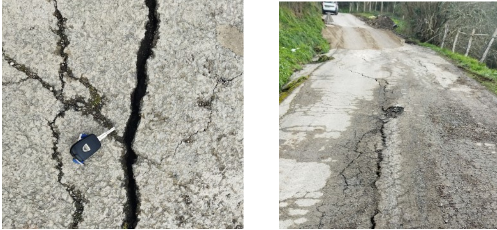
Fig 4: Grietas localizadas en la pista de acceso al barrio Partaitti.
