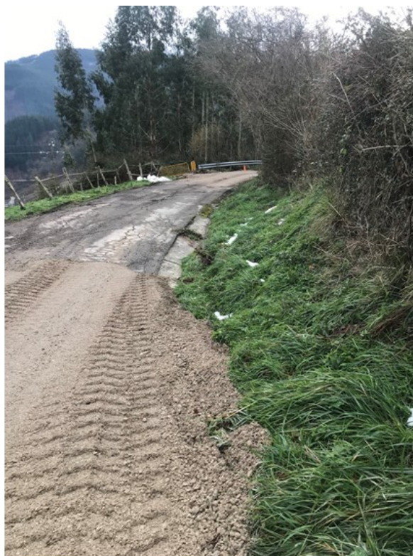
Fig 8: zona de afección a la carretera de acceso al barrio de Partaitti.
